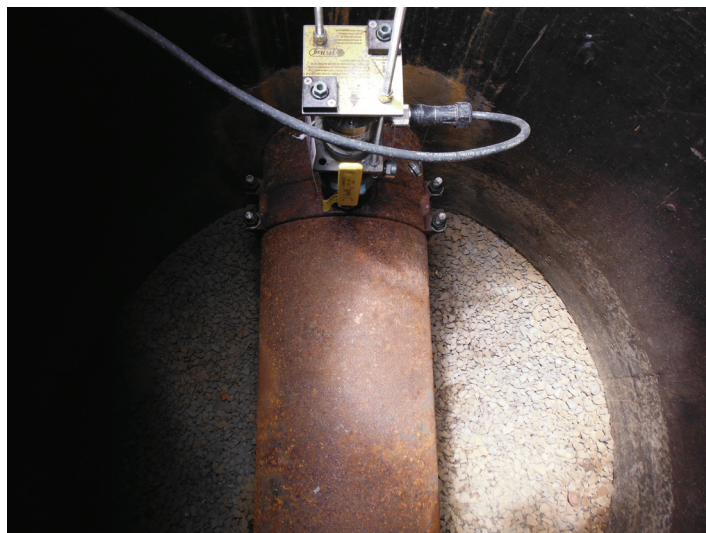
Figura 2: El caudalímetro FPI Mag instalado en el pozo de roca de sellado
